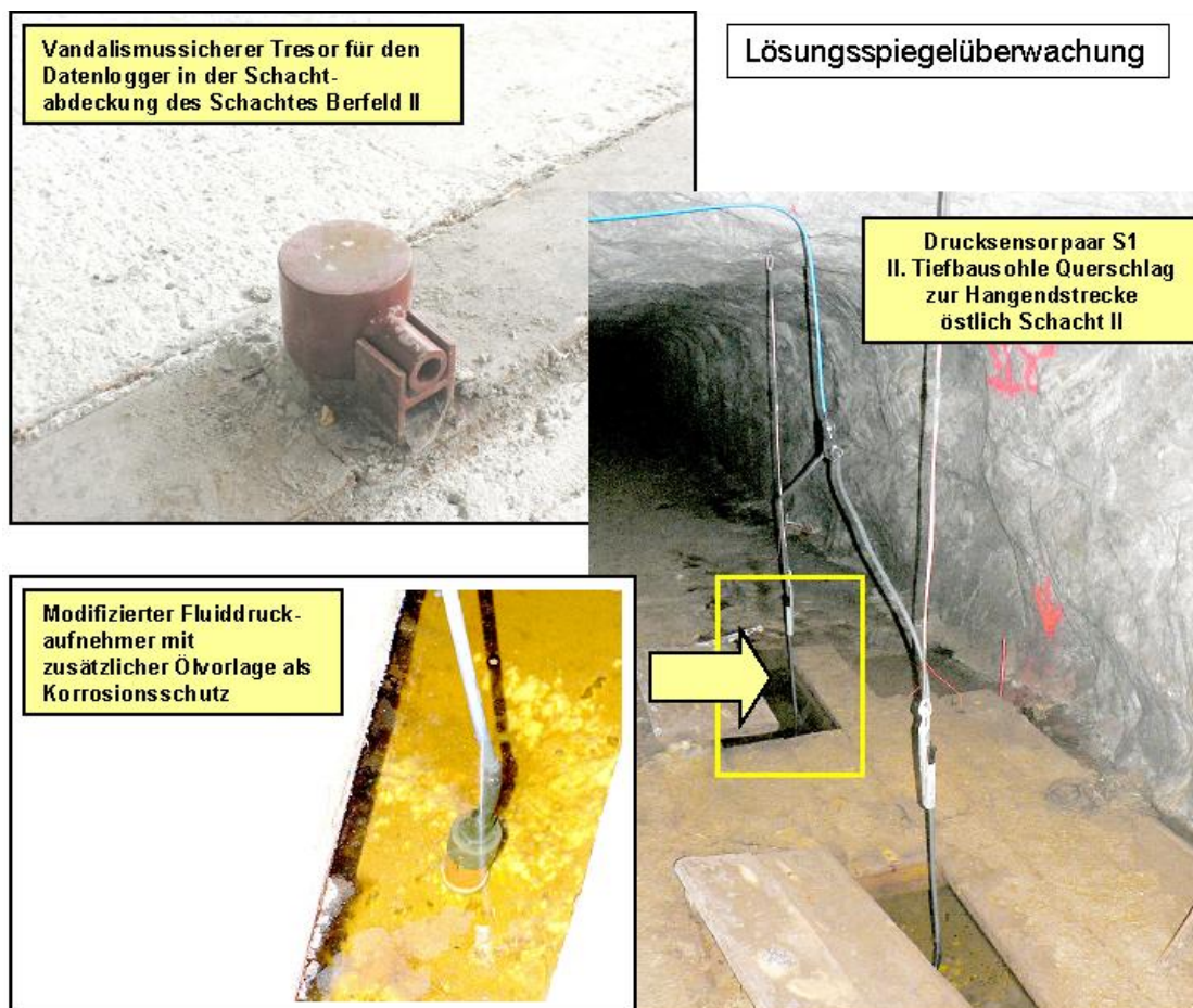
Abb.5 : Drucksensorpaar S1 auf der II. Tiefbausohle zur Überwachung des Lösungsstandes im Grubenfeld Brefeld I mit Detailaufnahmen des modifizierten Sensors und des Datenloggers am Schachtkopf des Schachtes Brefeld II
