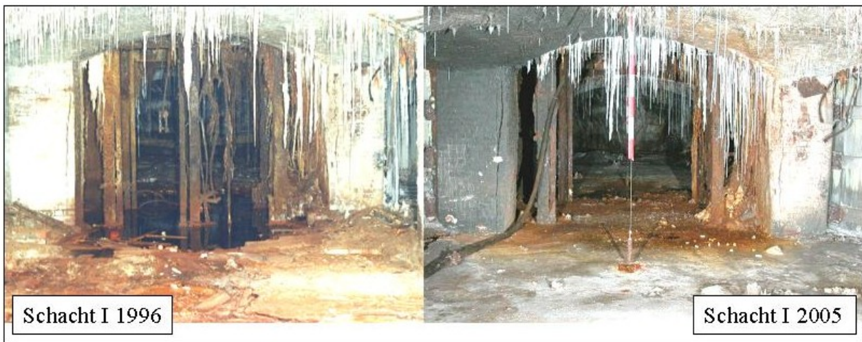
Abb.1 : Ansicht des Schachtes Brefeld I vom südlichen Schachtvorhof auf die Schachtröhre, links im Bild ist die Situation im Jahre 1996 mit Salzlösung und Verbrucherscheinungen im Sohlenbereich dargestellt, das rechte Bild zeigt die Situation im Jahre 2005
