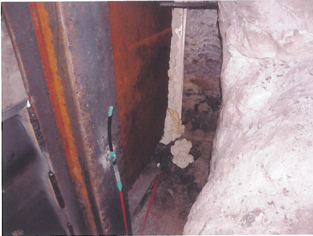
Abbildung KD 2: Übergang der eingefrästen Nut von der Sohle in den Stoß
