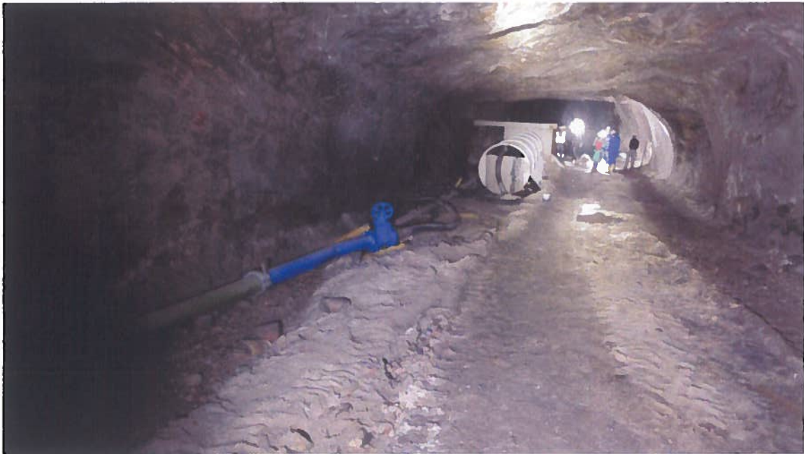
Abbildung KD 16: Bypassleitung zum Standort der Versuchsanlage
