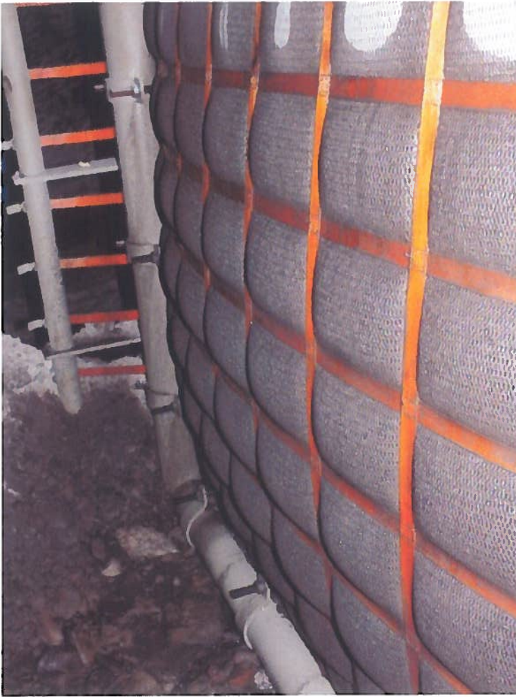
Abbildung K-UTEC 16: Detailansicht Filter mit Gurtnetz
