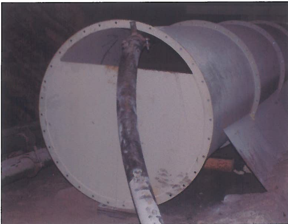
Abbildung K-UTEC 14: oberes Rohrende mit Suspensionsschlauch
